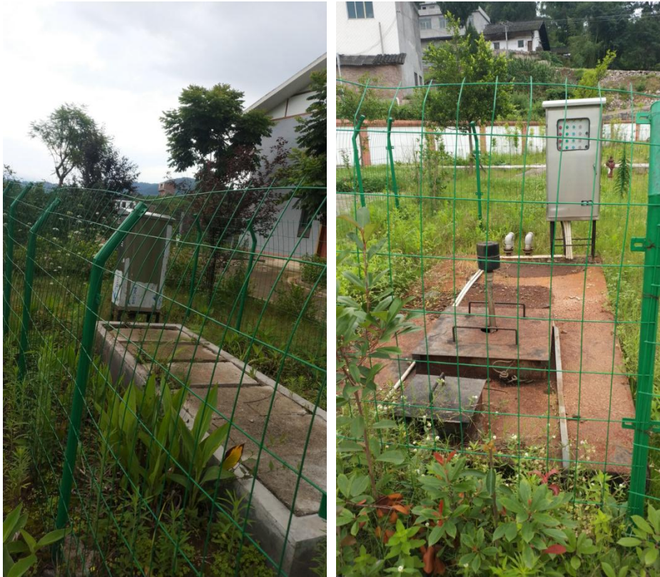
图 7.3-2 污水处理设施
